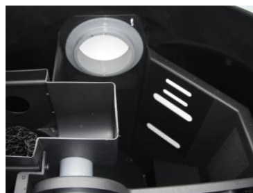
水位が上から4番目の 水位線を越えているときに測定・調整
