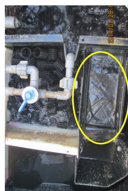
測定時に浄化槽が 放流していることを確認する
